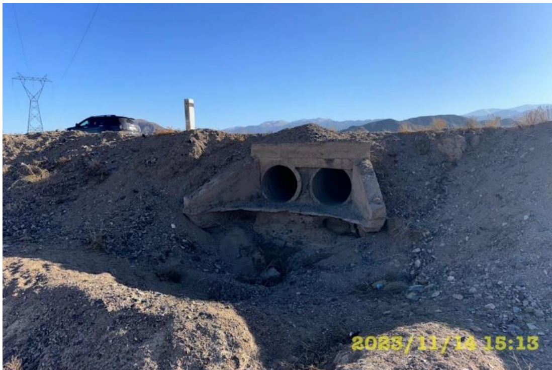
Фото 7. Состояние оголовков/открылок водоотводных сооружений на выходе. Эрозия почвы.
