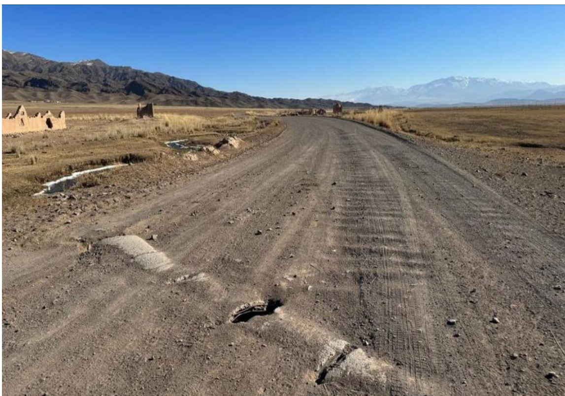
Фото 30. Состояние трубы водопровода
