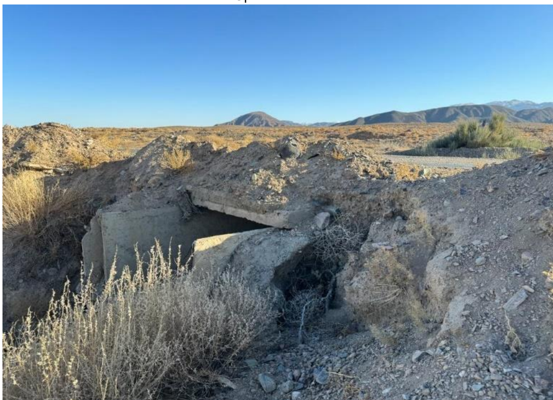
Фото 10. Состояние оголовков/открылок водоотводных сооружений на входе. Эрозия почвы.
