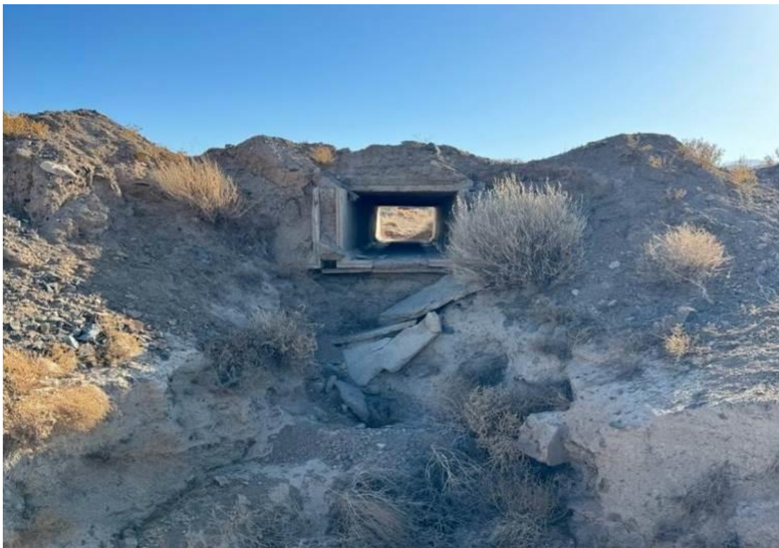
Фото 9. Состояние оголовков/открылок водоотводных сооружений на выходе. Эрозия почвы.
